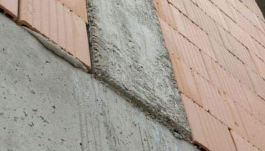
Vasbeton gerenda és pillér hibás csatlakozása
